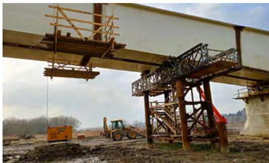
Zespolona do tej pory na podporach konstrukcja stalowa waży łącznie około 650 ton.
